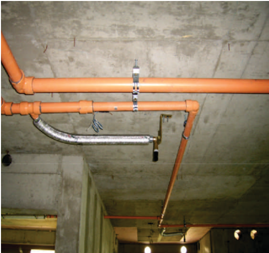
Đường ống phun nước ở căn hộ
