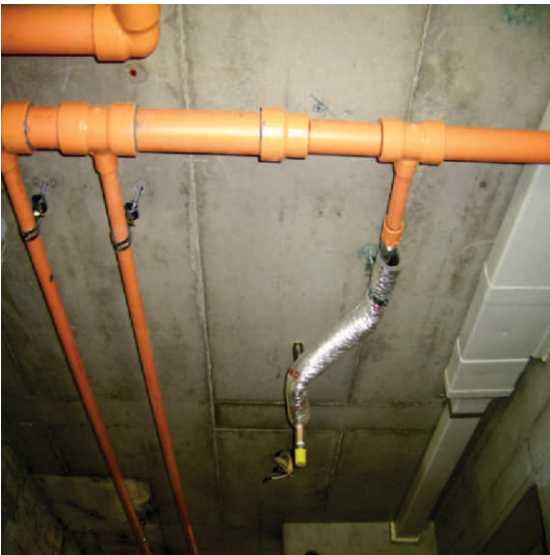
Đường ống phun nước ở căn hộ
