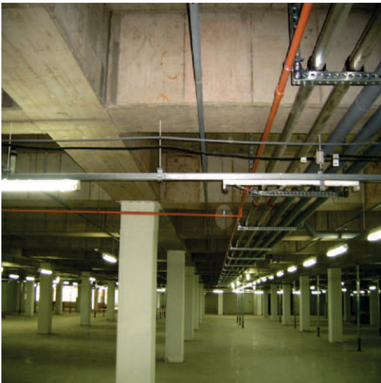
Đường ống ở Graywater Treating Facility
