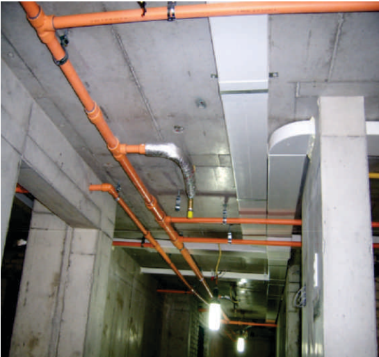
Đường ống phun nước ở căn hộ
